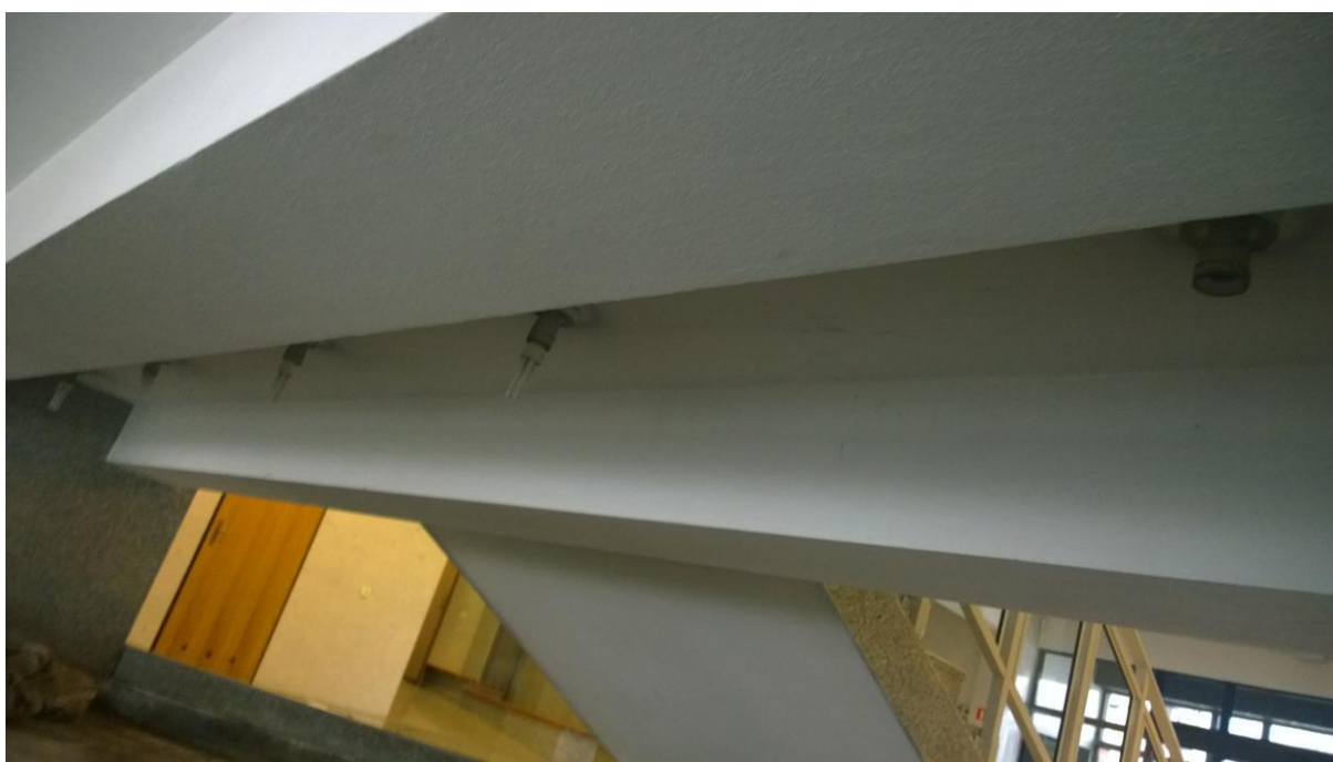
Fot. 4. Dotychczasowe punkty oświetlenia
